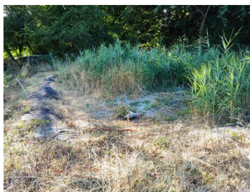
Premier étage du filtre planté de roseaux
