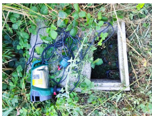
Regard de collecte des eaux usées traitées vers le bassin d'infiltration
