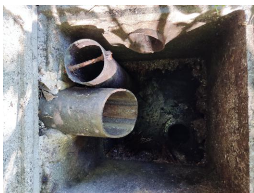
Regard de répartition
